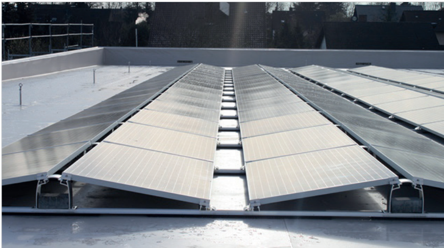
Hemsbach | Germania Instalație: 350 kW | Sistem D-Dome
