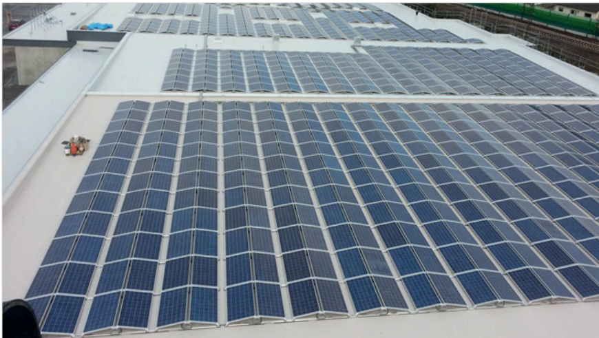
Hemsbach | Germania Instalație: 350 kW | Sistem D-Dome
