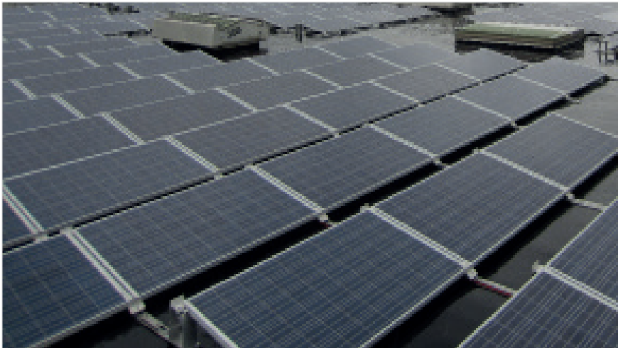
Kaiserslautern, Germania Instalație: 2,8 kW | Sistem S-Dome
