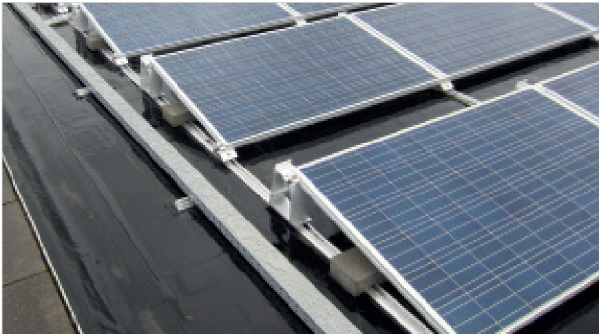
Kaiserslautern, Germania Instalație: 2,8 kW | Sistem S-Dome
